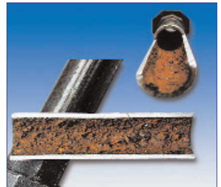
Este corte de tubería de hierro negro de aire comprimido muestra un contaminante típico y una restricción de flujo generados después de pocos años de operación.
